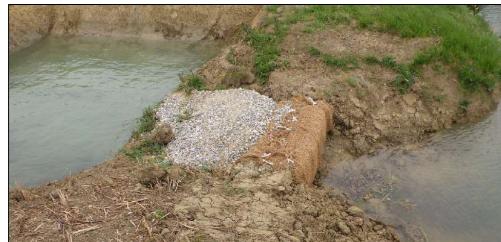
Figure 53 : Illustration d'un dispositif d'assainissement provisoire en phase chantier (filtre à gravier doublé d'un filtre à paille)
