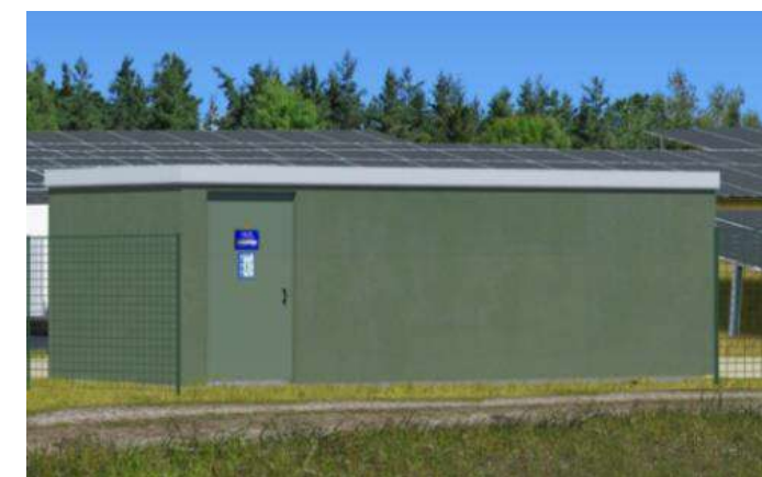
Figure 13 : Exemple d'un poste de livraison (Source : EDF Renouvelables)
