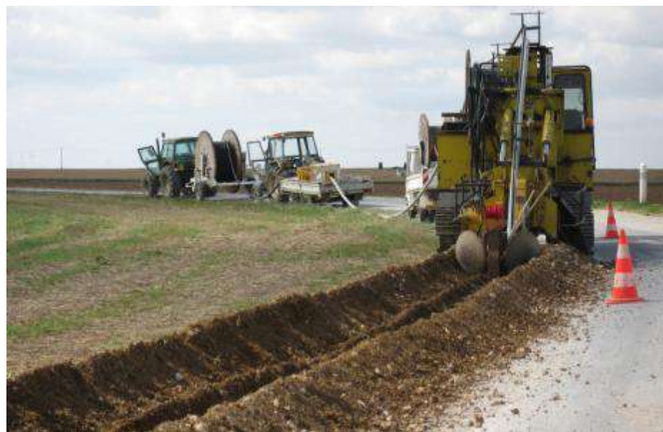
Figure : Illustration des travaux de raccordement réalisés par ENEDIS (source : EDF Renouvelables)
