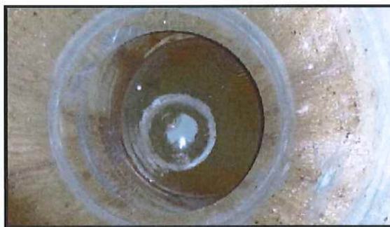
Intérieur du nouveau captage (n°1)
