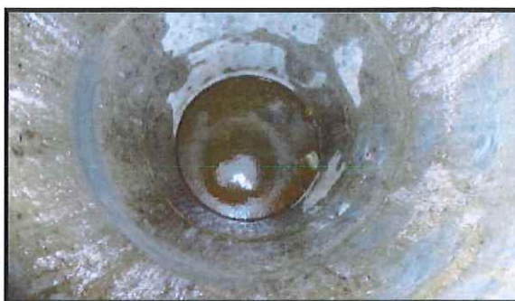
Intérieur du captage n°3
